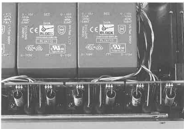
〈写真F〉電圧リミット基板は左サイドに配置
